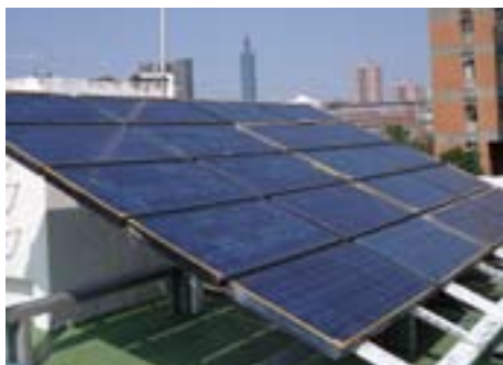
台大新能源中心屋頂的太陽能板
